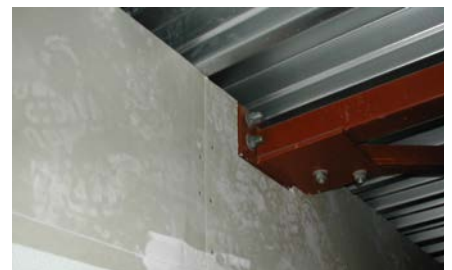
Figuur 25: Opening tussen dak en brandwerende wand: geen brandwerende scheiding
