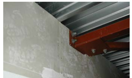
Figuur 20: Opening tussen dak en brandwerende wand: geen brandwerende scheiding
