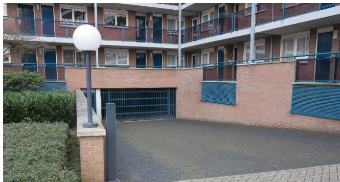
Figuur 1: Een Uitslaande brand in de garage zou in dit gebouw vluchten over de galerijen onmogelijk kunnen maken.
